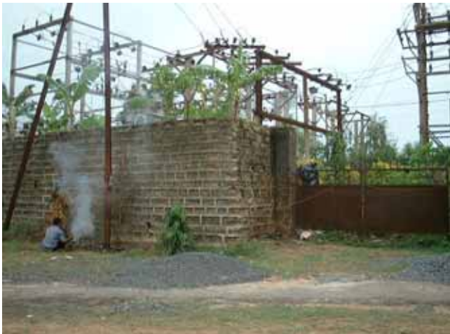
電力会社の変電所：ここから電気を引き込んでいる。
