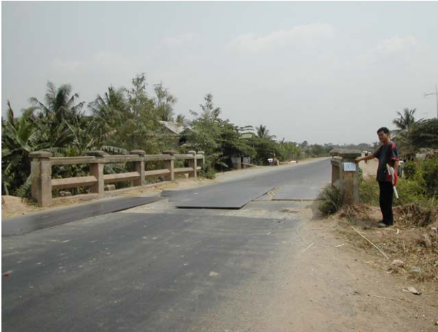
水門 BC-5の路面状況 STA.41+006付近
