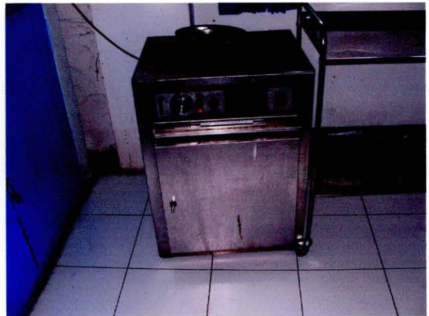
シンタン県立病院（乾熱滅菌器） 老朽化のため故障、使用できず
