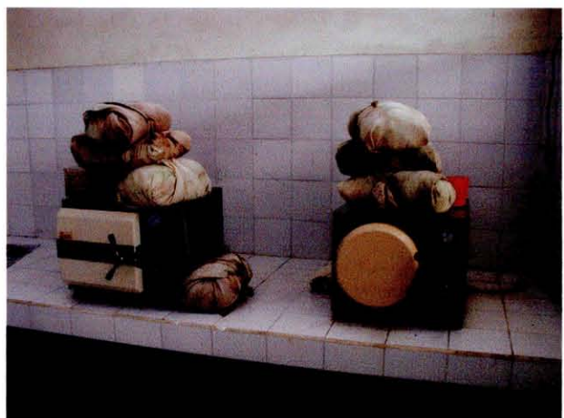
サンバス県立病院（蒸気滅菌器） 容量不足に加え老朽化が著しく器具滅菌に支障が生じている
