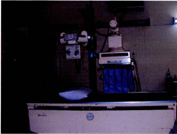
スダルソ州立病院（透視撮影 X 線装置） 設置後 20 年以上経過し老朽化が著しい
