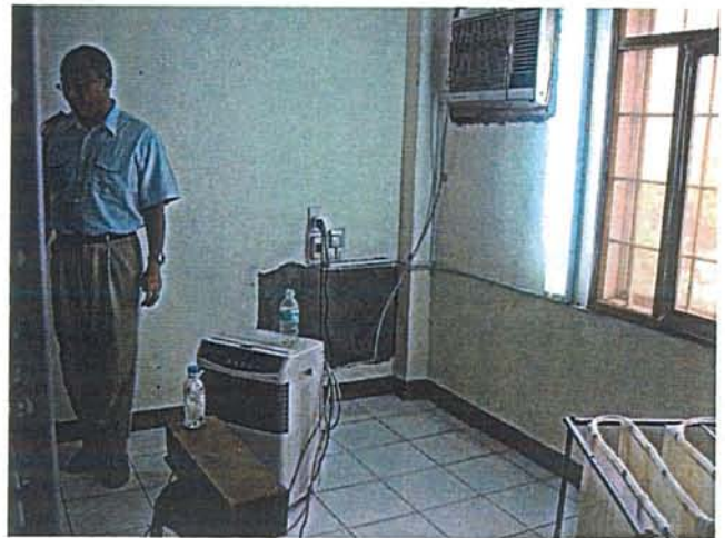
写真 10 : 空調装置 (温湿度調整)
