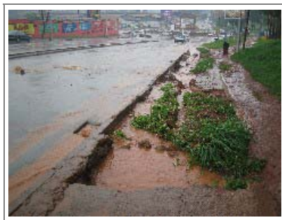
排水施設の不備により浸食されたジンジャ道路歩道
