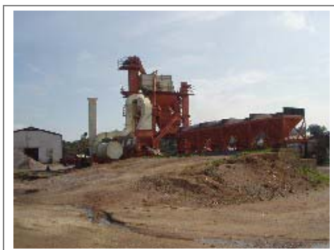
アスファルトプラント(セメンターズ)
