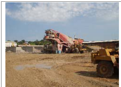
コンクリートプラント(セメンターズ)
