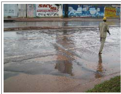
不陸の顕著なジンジャ道路(降雨時)
