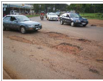
ポットホールの著しいジンジャロードRA周辺
