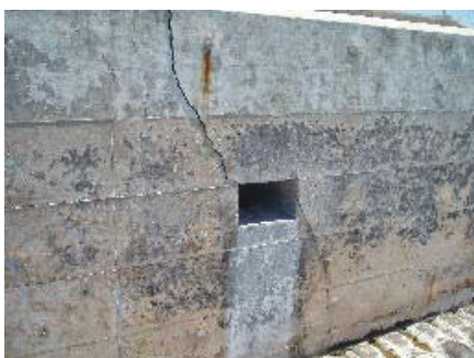
⑦ パラペットひび割れ状況 (陸側)
