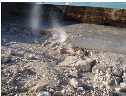
② 道路部からの海水の噴出 (No.1 付近)
