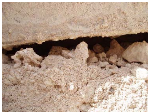
ファブリマツ下面での隙間
