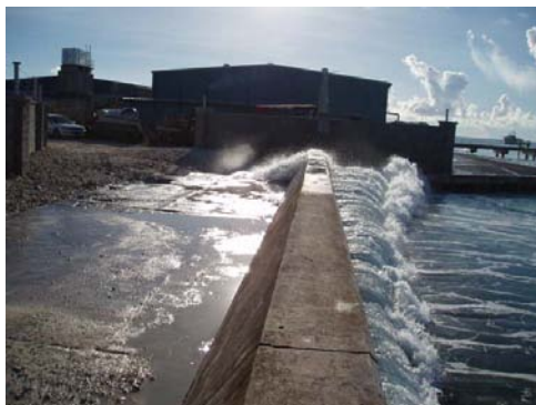
① 越波状況 (No.1 付近)
