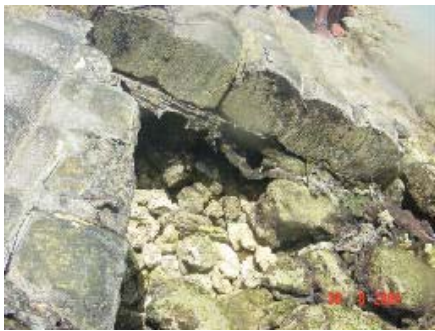
③ 裏込石流出状況
