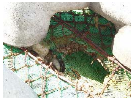
⑥ ブロック下の布団籠損傷状況
