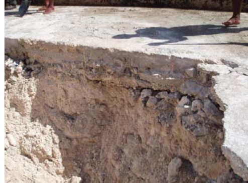
コンクリート下面での隙間
