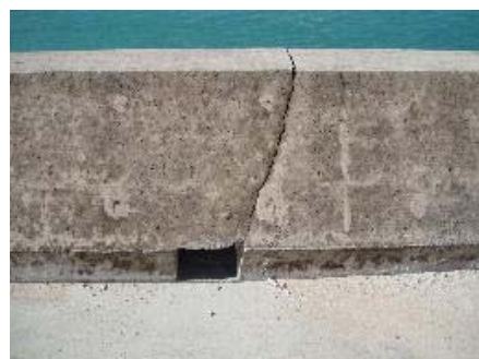
⑧ パラペットひび割れ状況 (海側)
