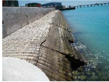
② 法肩部の亀裂 (No.10 付近)
