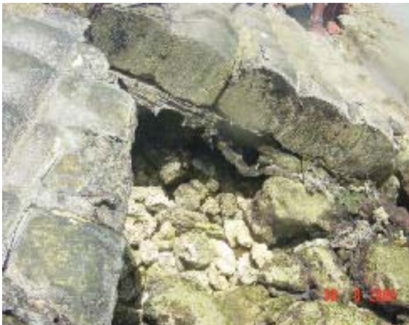
ファブリマツ護岸の損傷状況(3)
