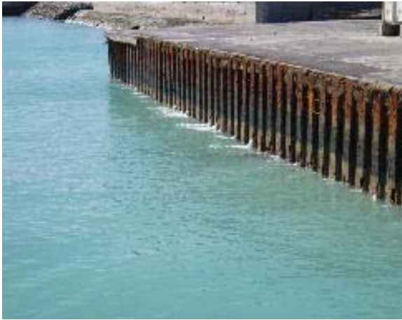
水産栈橋取付護岸の損傷状況(1)
