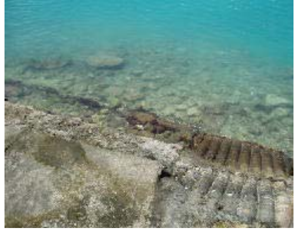
ファブリマツ護岸の損傷状況(2)
