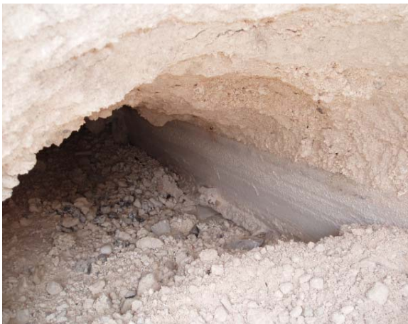
ファブリマツ護岸の損傷状況(5)
