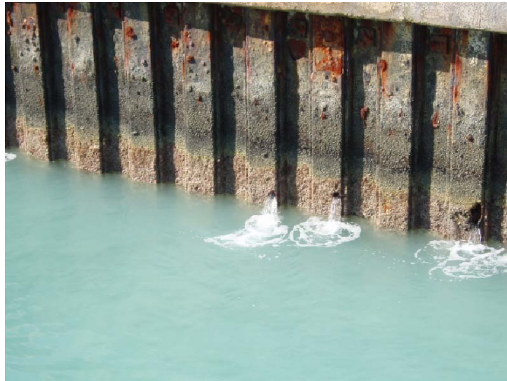
写真 2-3 既設鋼矢板の腐食状況
