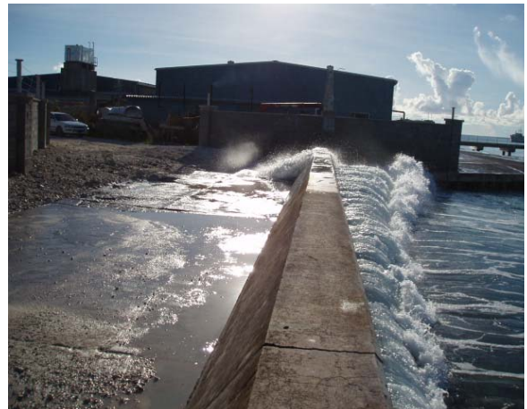
ファブリマツ護岸の損傷状況(4)
