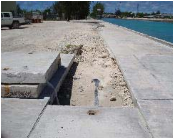
水産栈橋取付護岸の損傷状況(3)
