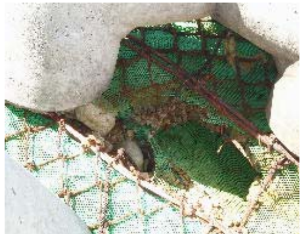
消波ブロック護岸の損傷状況(1)
