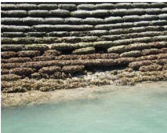
東防波堤護岸の損傷状況(2)
