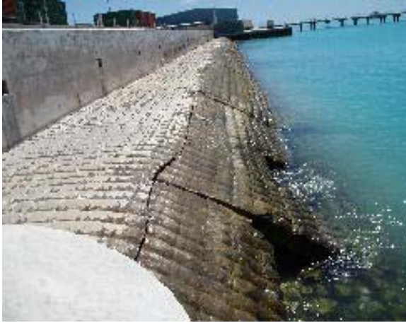
ファブリマツ護岸の損傷状況(1)
