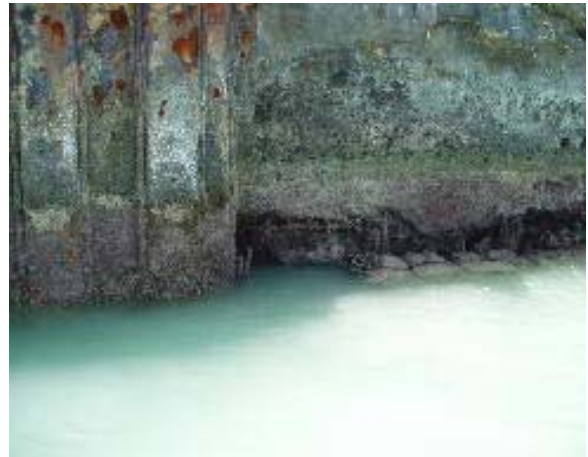
東防波堤護岸の損傷状況(1)
