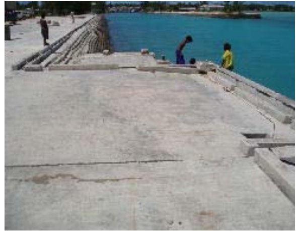
水産栈橋取付護岸の損傷状況(2)
