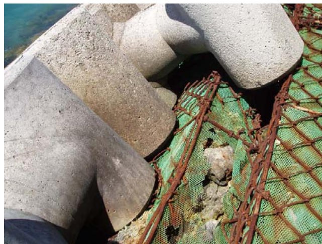
写真 2-2 消波ブロック下面の布団籠の腐食状況
