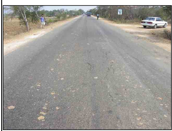
RN6A 43Km+600付近。一部に大きな轍と亀甲状クラックが見られる。
