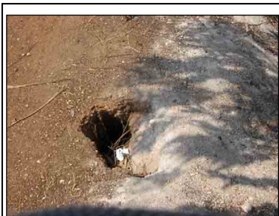
RN6 Br.F3脇に見られるドラゴンホール。
