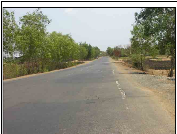
RN7 Br.10の軟弱地盤が確認された区間。路面が大きく波打っているのがわかる。
