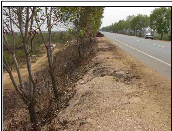
RN6 Br.F2取り付け部斜面。斜面浸食(崩壊)が著しく、オーバーハング状の区間もある。
