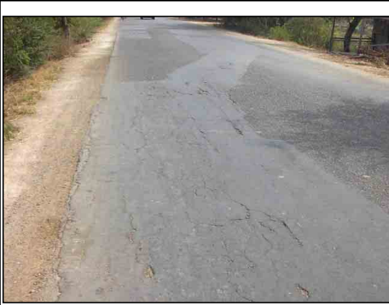
RN6A Br.10と11の間。オーバーレイされた舗装に亀甲状のクラックが見られる。
