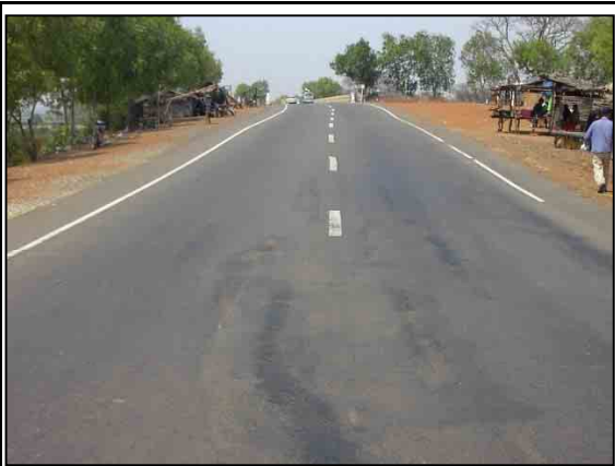
RN6 Br.2取り付け部の舗装。補修された舗装が再度沈下している。
