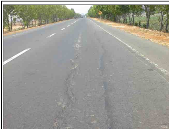
RN6 Br.F3取り付け部の舗装。補修された舗装が再度流動している。
