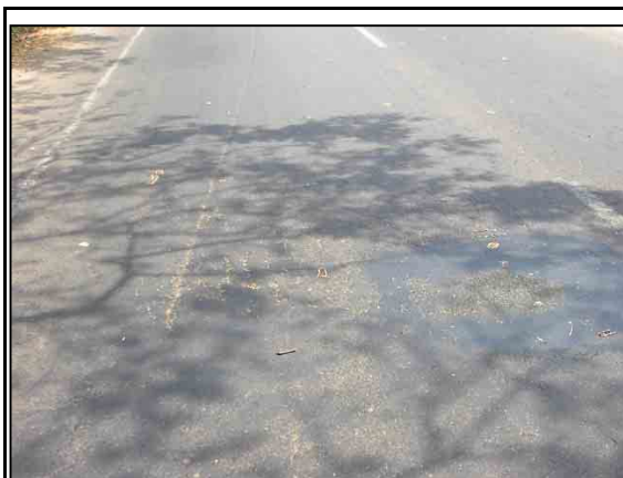
RN6 65Km付近。状態の良好な区間であるが、稀にクラックや剥離が見られる。
