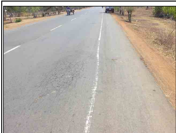
RN7 約80Km付近。舗装の側方流動、亀甲状クラックが見られる。
