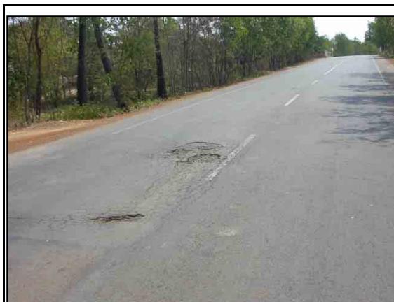
RN7 スクンを過ぎた地点。所々に亀甲状クラックと舗装の剥離が見られる。
