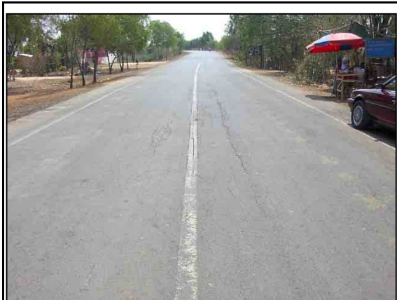
RN7 76Km+500付近。舗装の流動、クラック、剥離ともに著しい区間。
