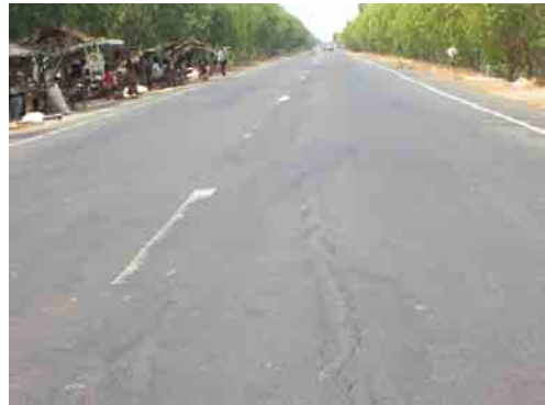
写真 2.1.2 路体の変状により流動する舗装
