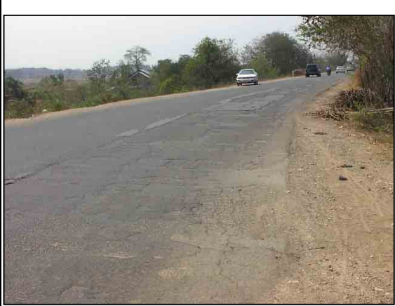
RN6A Br.25と26の間。亀甲状のクラックが多数見られ、路肩部分は舗装が破壊されている。
