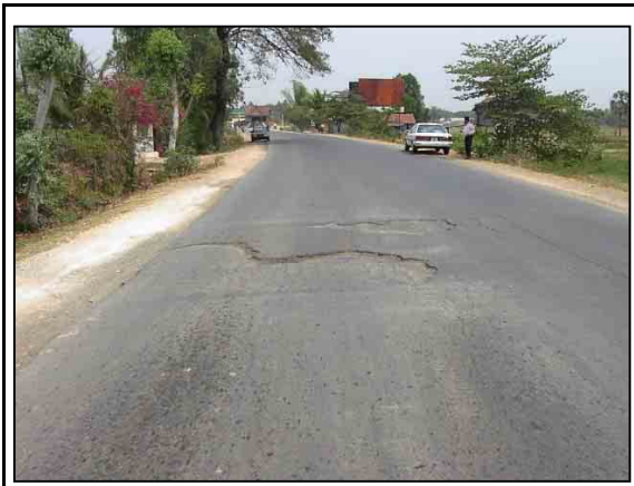
RN6A 31Km付近。大きな舗装の剥離が見られる。
