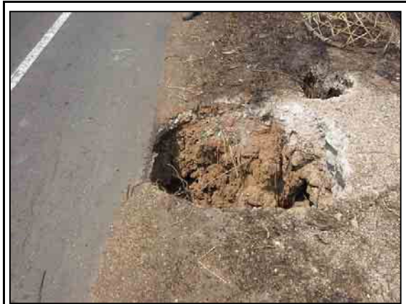
RN6 Br.F2脇に見られるドラゴンホール。
