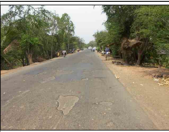
RN6A Br.14手前の集落区間。亀甲状クラックと舗装剥離が著しい。
