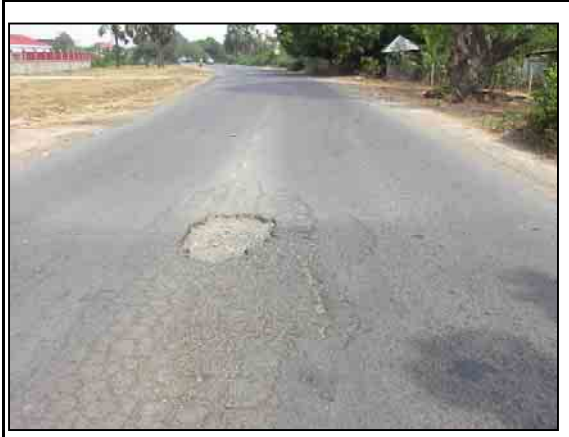
RN6A 26Km付近。亀甲状クラックが進行し、舗装の剥離が見られる。
