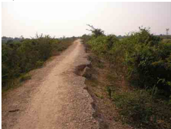
写真 2-5-6 国道6号線 48.5km から北に伸びる堤防 主に北側（右側）の路肩が浸食により崩壊し、 堤防天端幅が狭くなっている。
