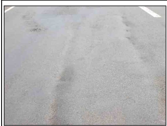
RN6 Br.2取り付け部の舗装。舗装の側方流動にも見えるが、盛土の側方移動が考えられる。
