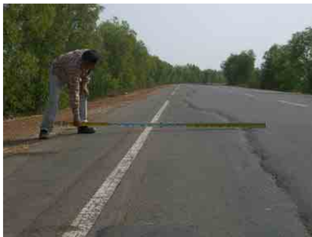
写真 2-5-3 国道6号線の縦クラック（2号橋付近）
