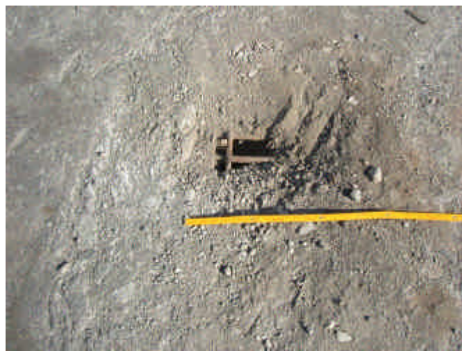
BL3-2 床版開口部の損傷状況詳細
