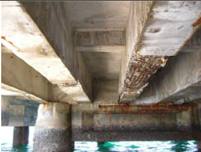
BL7 前 6-7 梁の損傷状況
