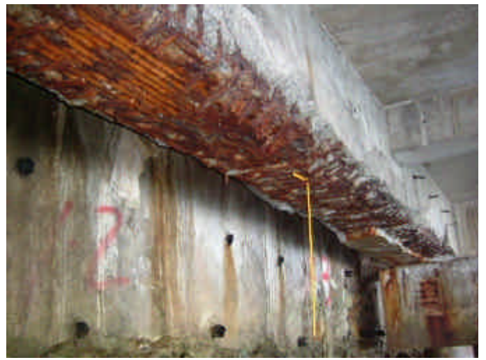
BL1-2, BL1-3 梁の損傷状況
