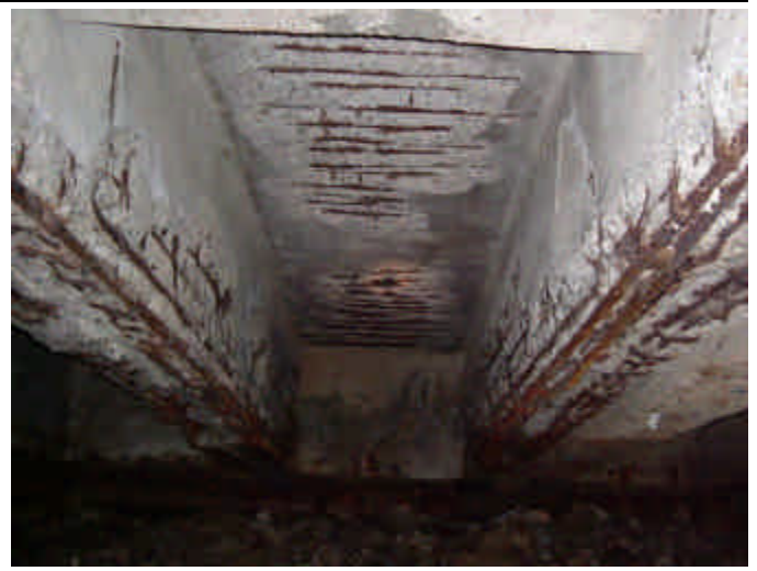
BL7 後 5-6 梁・床版の損傷状況
