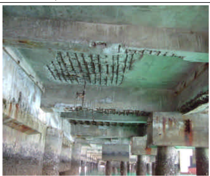
BL4-5, BL4-6 床版・梁の損傷状況
