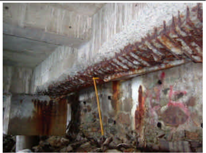
BL1-4, BL1-5 梁の損傷状況
