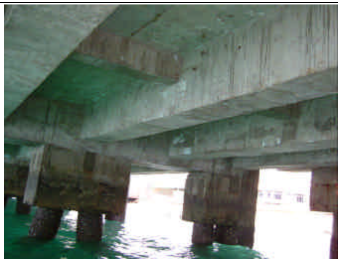
BL5-6, BL5-7 梁の損傷状況
