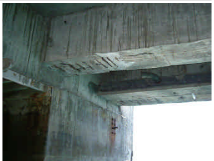
BL6-7 梁の損傷状況
