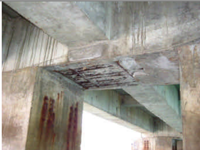
BL6-6 梁の損傷状況
