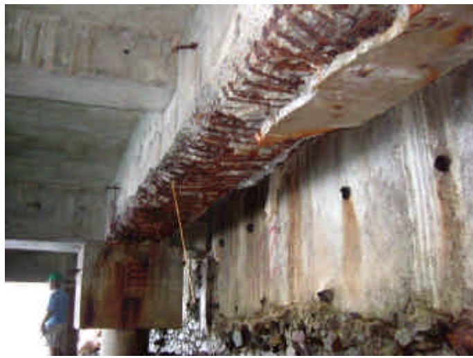
BL1-2, BL1-3 梁の損傷状況
