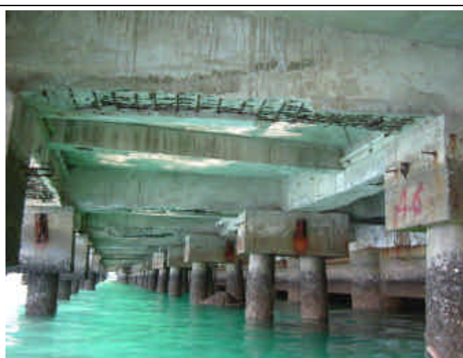
BL4-1, BL4-6 梁の損傷状況 (終点 始点)
