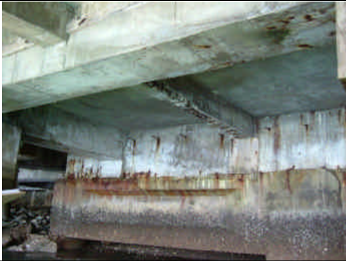
BL3-1, BL3-2 中間梁の損傷状況
