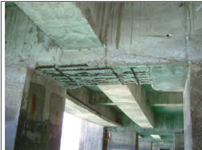
BL5-6 梁の損傷状況
