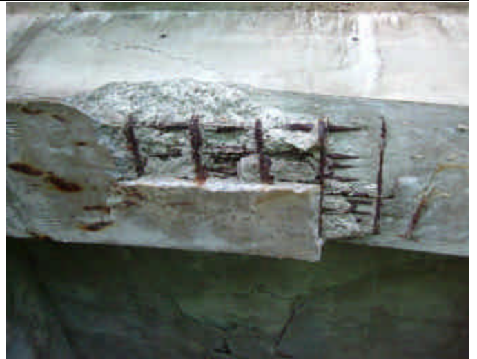
BL3-3, BL3-4 中間梁の損傷状況
