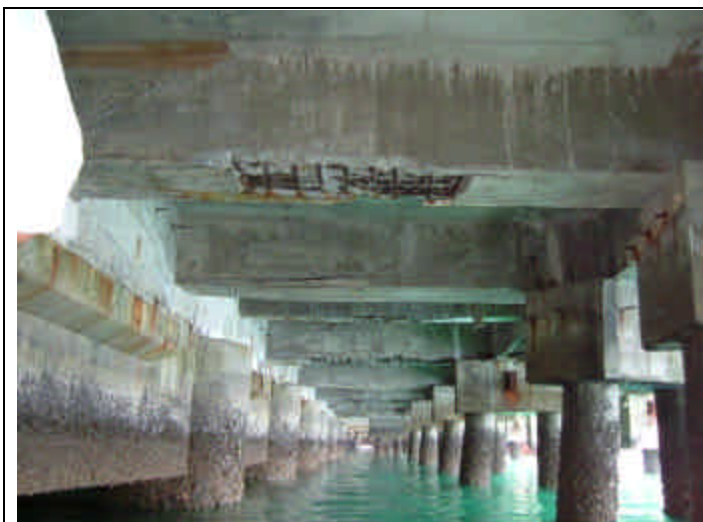
BL4-1, BL4-4 梁の損傷状況 (始点 終点)
