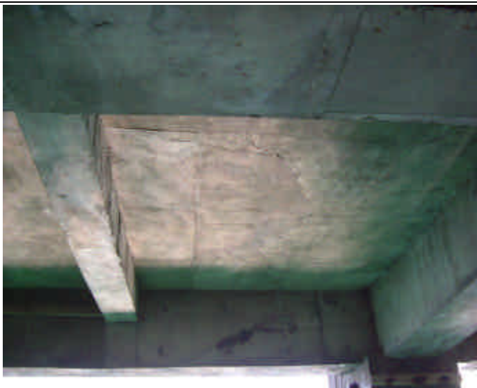
BL3-4, BL3-5 床版のクラック損傷状況
