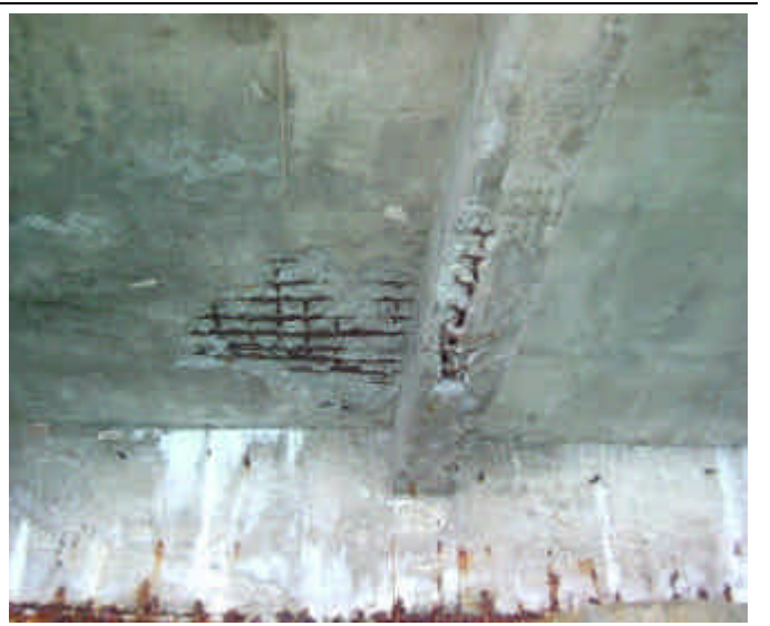
BL3-5, BL3-6 床版の損傷状況
