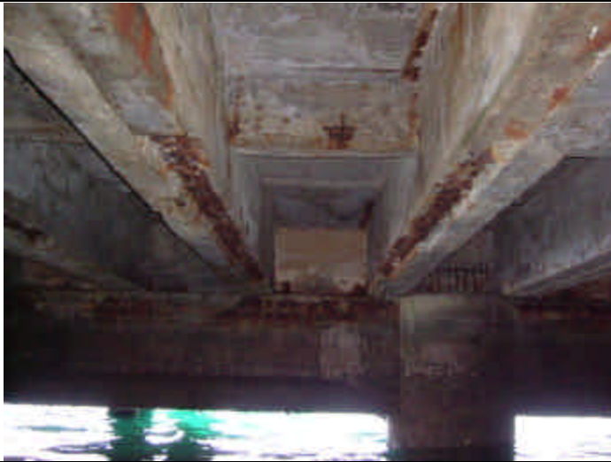
BL7 前 4-5 梁の損傷状況
