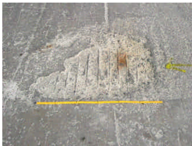
BL4-4 床版の損傷状況詳細
