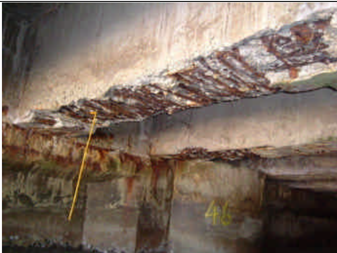
BL7 後 6-7 梁の損傷状況
