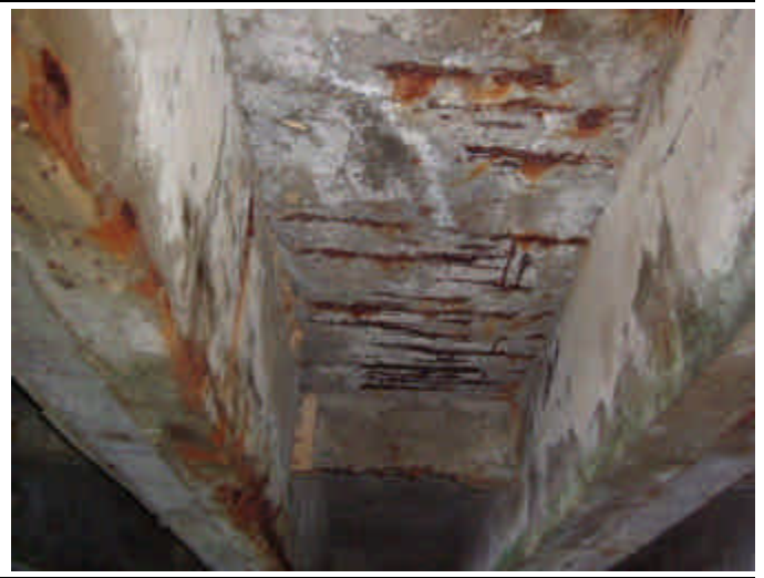
BL7 前 5-6 梁・床版の損傷状況
