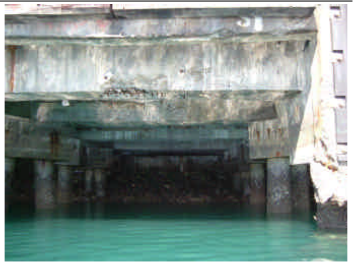
BL1-5, BL1-6 梁の損傷状況
