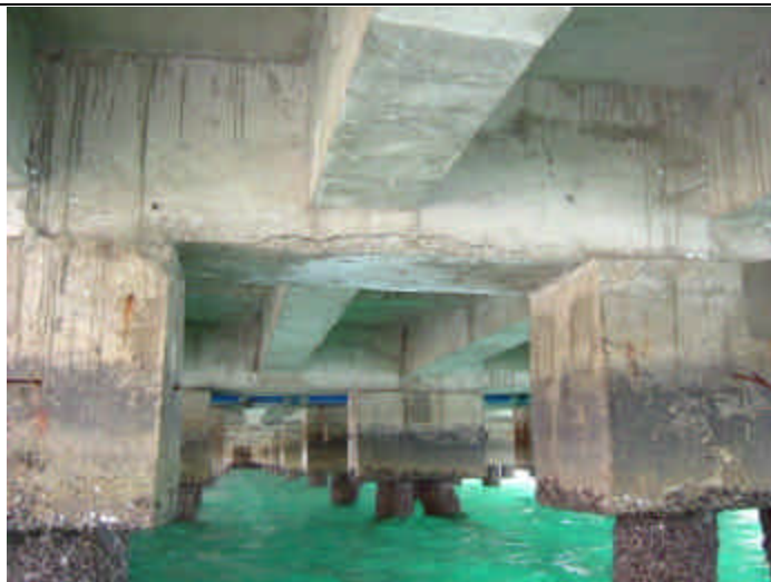
BL5-7, BL5-8 梁の損傷状況
