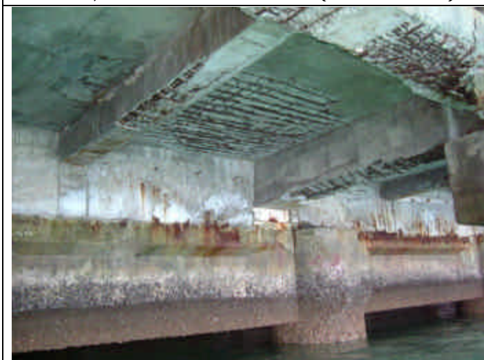
BL4-2, BL4-3 床版・梁の損傷状況
