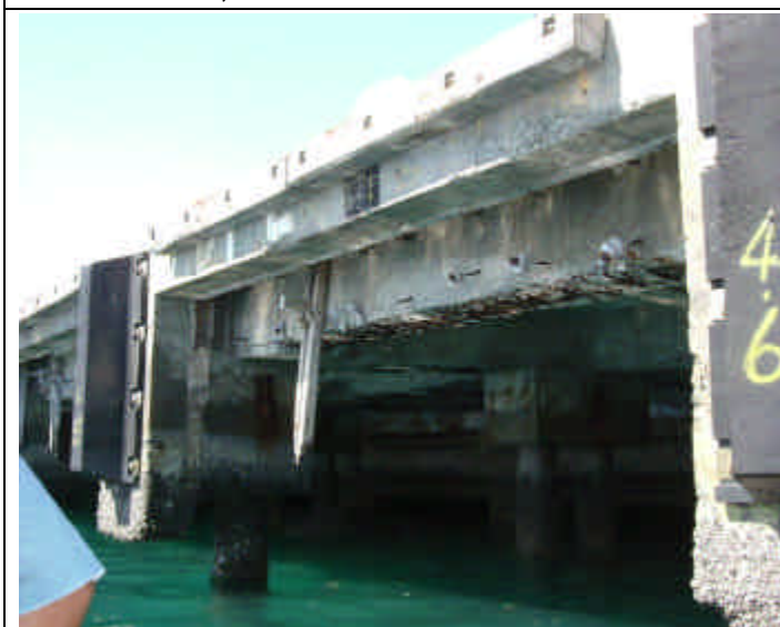
BL4-5, BL4-6 梁の損傷状況
