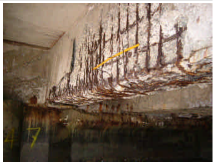
BL7 後 6-7 梁の損傷状況
