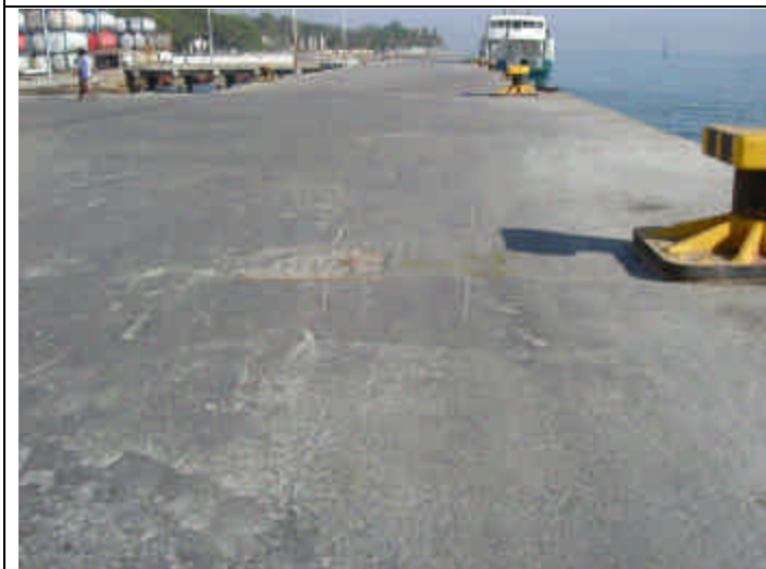
BL4- 4床版の鉄筋露出状況
