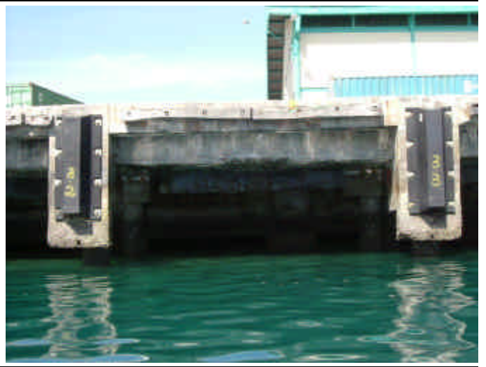
BL3-2, BL3-3 前面梁の損傷状況
