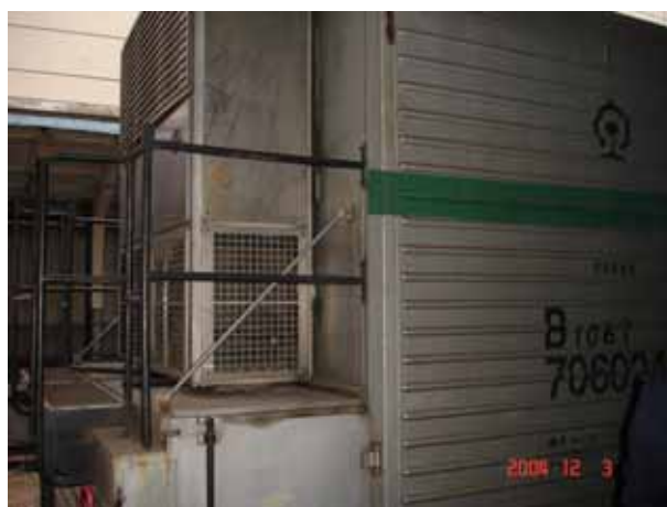
図表 131 : 引込線上の冷蔵コンテナ、ディーゼルエンジン発電機部分
