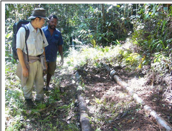
水源直下のパイプライン （1 日前に修理したばかりとのこと）
