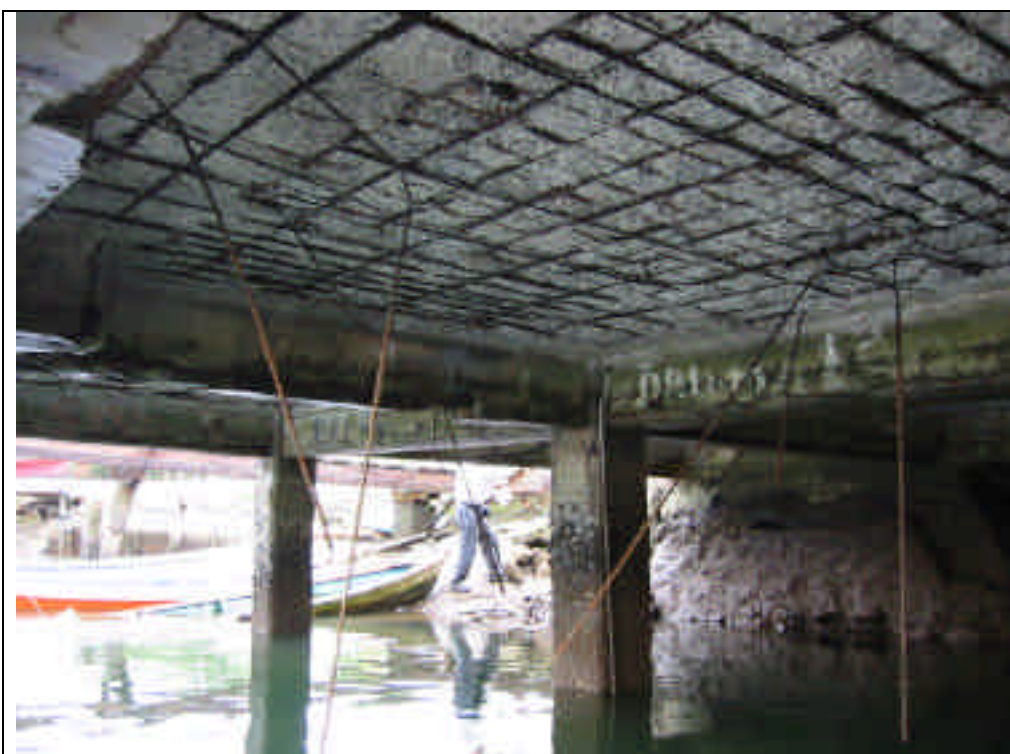
水産局ラミ栈橋 エプロン部（劣化が著しい床版下部）
