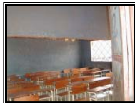
教室内部、壁を壊して使用している
