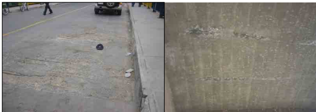
損傷が激しい床版 (エクアドルを望む)
