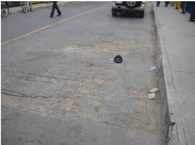
床版は激しく損傷し、鉄筋が露出している。
