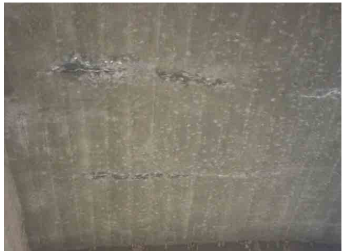
亀裂は床版下端に達し、遊離石灰が見える。
