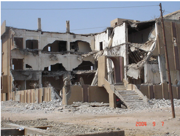
Qibleh 市内交換局 (Basra 市内) 破壊局舎
