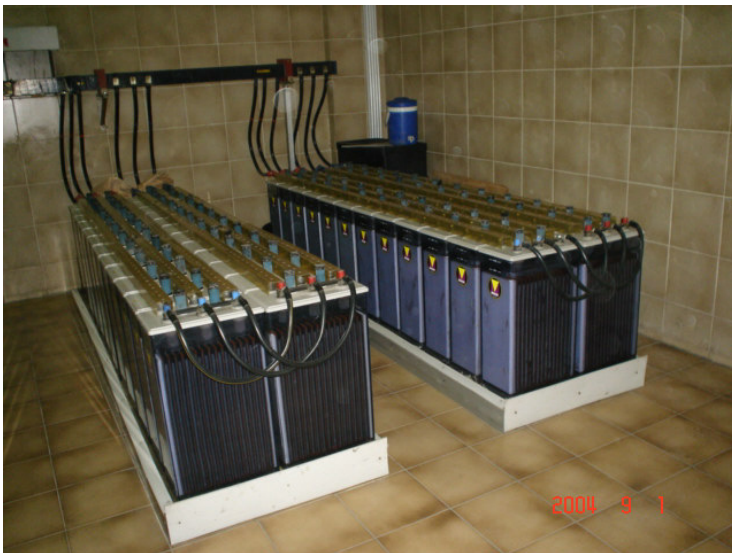
Baghdad I 中繼・市外局 蓄電池
