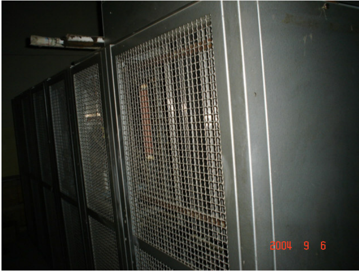
Mosul 中継交換局 整流器
