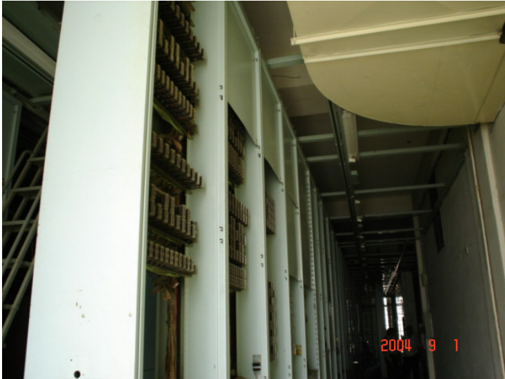
Baghdad I 中繼・市外局 Thomson CSF 中繼交換機 (20,000 回線) 交換設備
