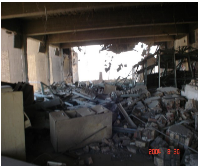
南ルートマイクロ波伝送路 Sink 無線局 損壊した局舎内部
