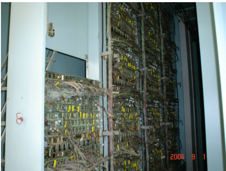
Baghdad II 中繼・市外局 Thomson CSF 中繼交換機 (20,000 回線) 交換設備 (架背面)
