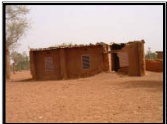
バンコ造につき、状況は極めて劣悪
