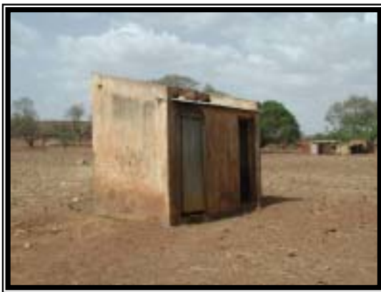
既存便所棟（使用不能状態）
