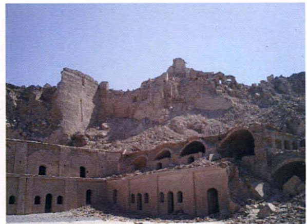
Governor's Area：崩壊状況
