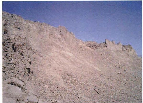
城壁北側部：崩壊状況（外側より）
