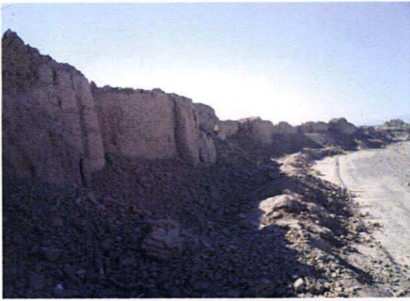
城壁西側：崩壊状況（外側より）
