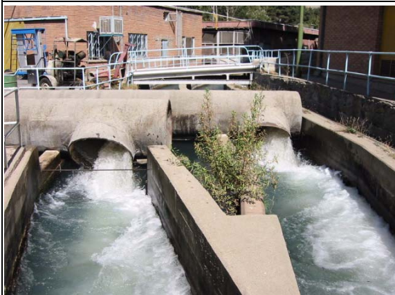
テラガンからビラガン取水への導水管の出口 (No.2 浄水場へ送水)
