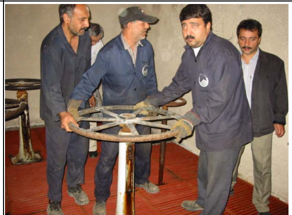
配水池の手動式止水弁を操作する職員 (自動遮断弁でないため地震時の緊急用水確保に問題あり)
