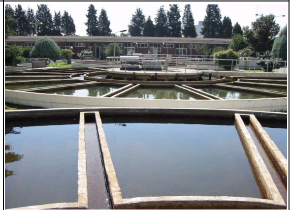
市中心部にある No.1 浄水場の沈殿池 (No.1 浄水場敷地内に TPWWC の本部がある)
