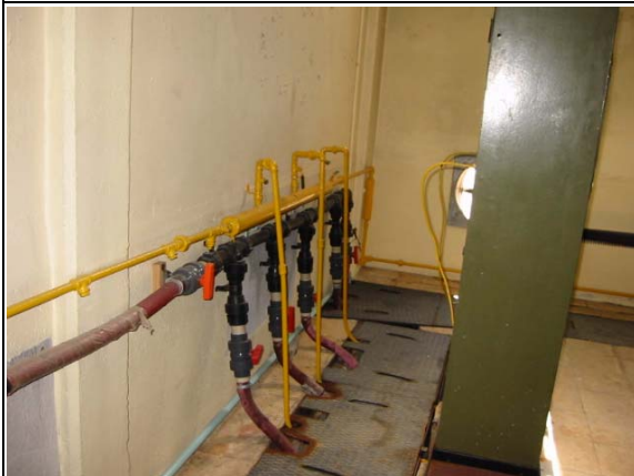
井戸を水源とした配水池にある塩素注入装置 (一部の井戸では下水の地下水への混入による水質汚染が懸念されている)
