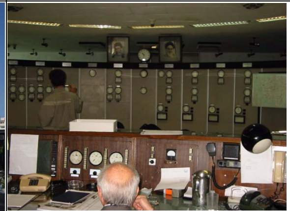
既設コントロールセンター内部の 運転監視施設
