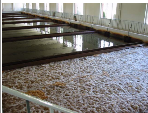
No.1 浄水場のフィルター槽の逆洗風景
