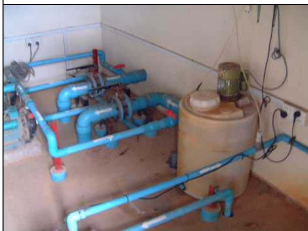
写真-11: ホテルの地下水揚水用ポンプ
