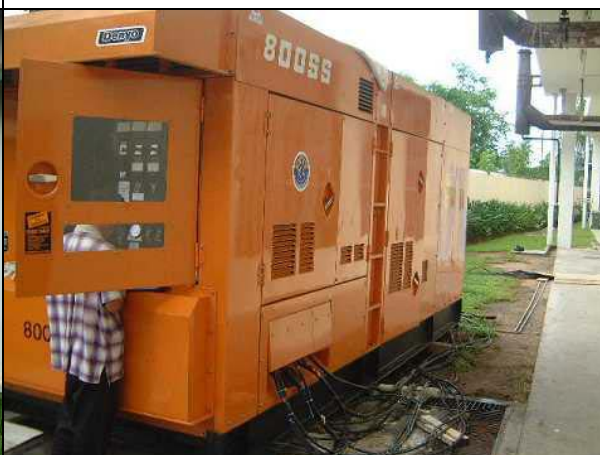
写真-10: ホテルの自家発電機
