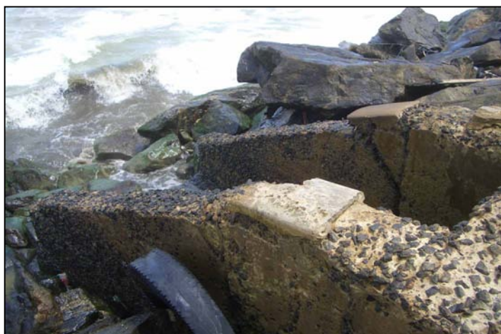
写真-20：下水管から汚水が未処理でオーバーフローされている
