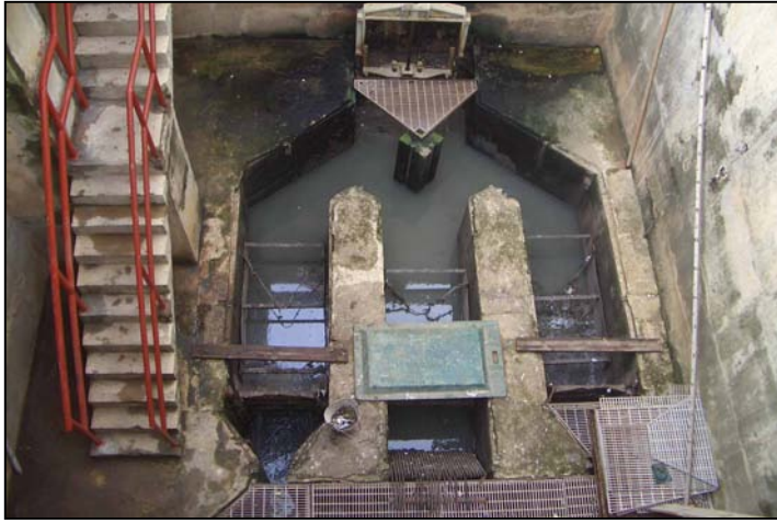
写真-17：ポンプ場流入水路（マウントレーニアポンプ場）
