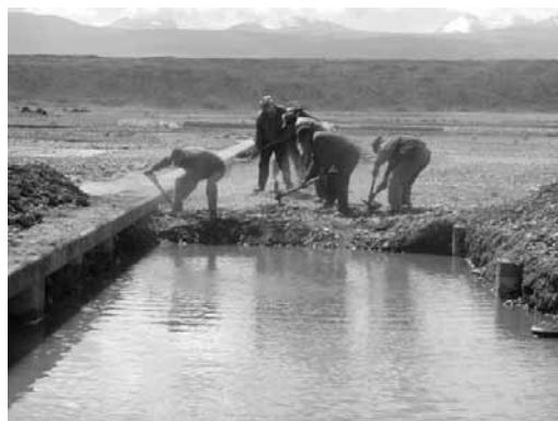
Puente sumergible en la época de crecida (Sedimentación de los materiales del lecho) Fuente: UCPA
