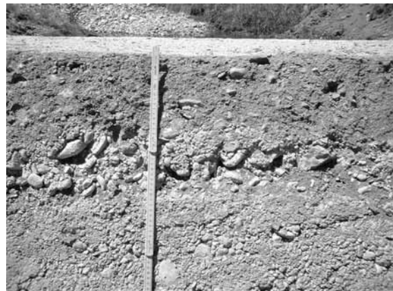
コンクリートの粗悪な仕上がり
