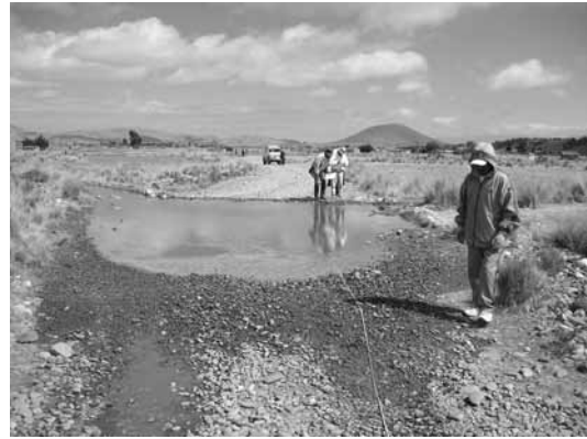
用水路横断による交通障害
