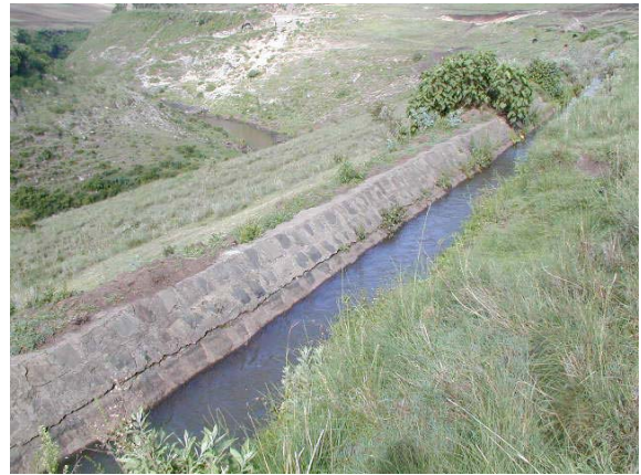
クラックからの漏水により流下能力が低下した幹線水路
