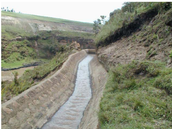
改修前の幹線水路
