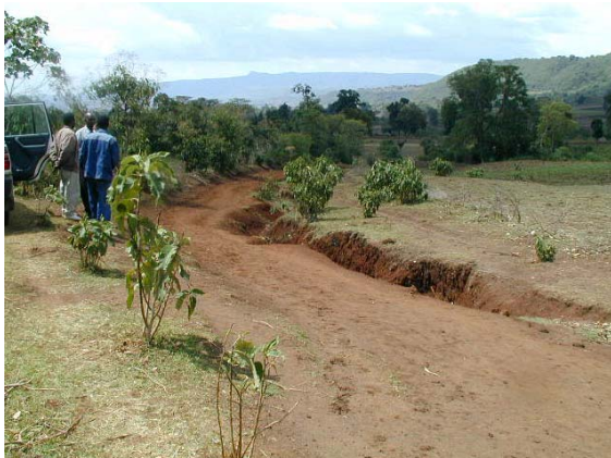
がり侵食によるアクセス道路の劣化
