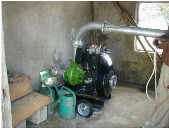
灌漑地区に設置した10馬力ポンプ
