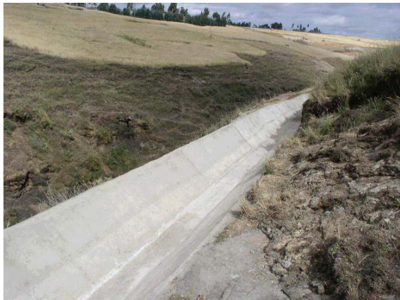
漏水が大幅に改善され流下能力が向上した改修後の幹線水路
