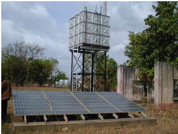
ソーラーによる給水設備(パネル故障中)、 Bole
