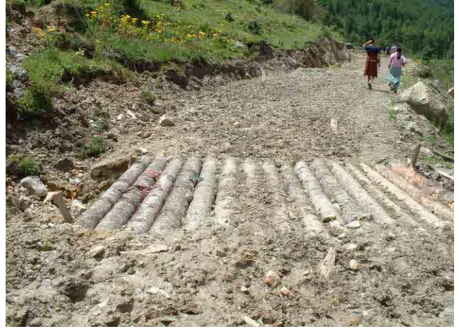
工事中の農村道路：横断排水部が木材で施工され、掘削が充分でないため、雨期には排水不良となり路面は冠水する。
