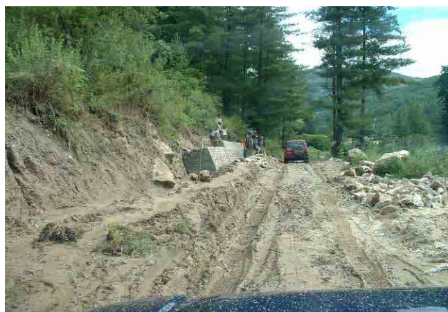
工事中の農道の現況(東部地域) 雨で路面が泥濘化し、通行が困難である。
