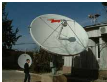
写真 2.1-27 衛星伝送用パラボラアンテナ
