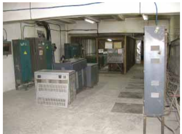
⑥ 電源設備
