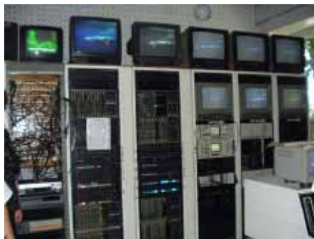
写真 2.1-20 旧局舎 主調整ラック
