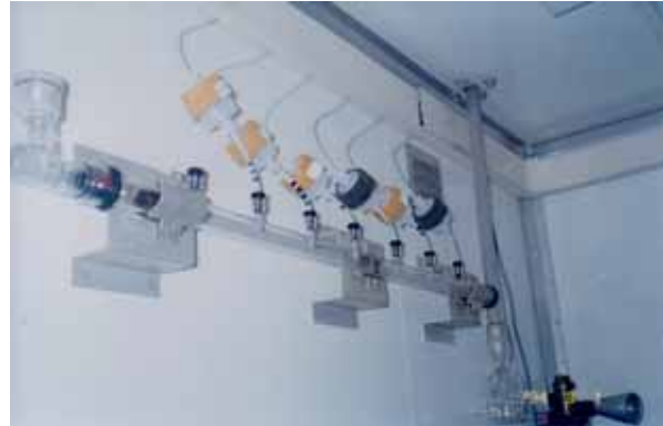
Figura 7 Manifold Horizontal sin aislamiento térmico
