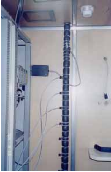
Figura 6 Manifold Vertical con aislamiento térmico
