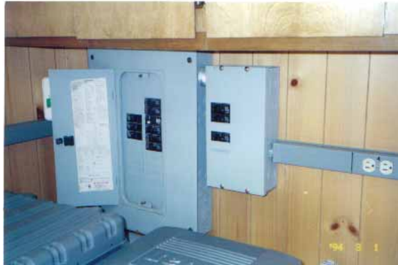
Figura 6.1 Tablero de distribución de energía eléctrica en estación de monitoreo
