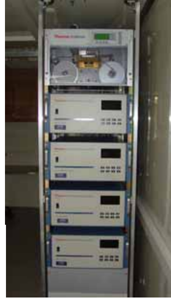
Estante o "Rack" de colocación de instrumentos de medición, metálico y con rieles de desplazamiento para facilitar el montaje y el mantenimiento in situ
