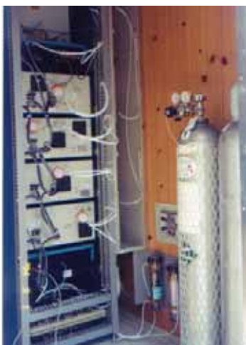
Figura 6.2 Tanques de gases comprimidos en estación de monitoreo sin sujeción
