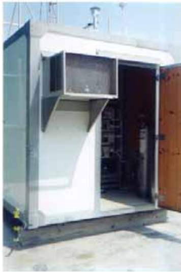
Figura 4.4 Equipo de Aire Acondicionado en una Caseta de Monitoreo
