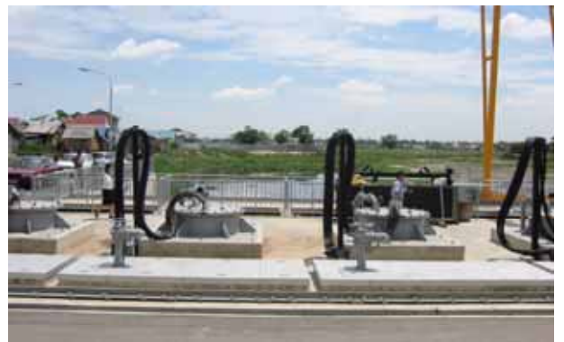
上流側に設置された排水ポンプ Tompunポンプ場(無償資金協力)
