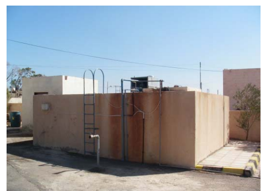
消防署の敷地内に貯水槽を設置し、 消火用水を確保し、消防車両に供給している。
