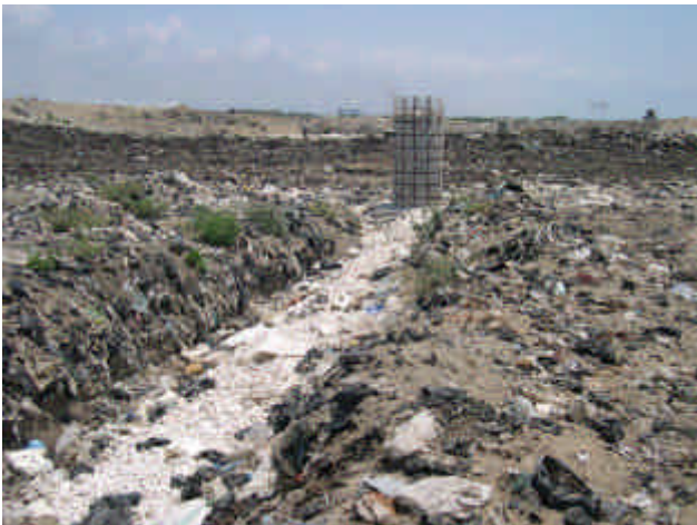
浸出水収集とガス抜きを兼ねたパイプ
