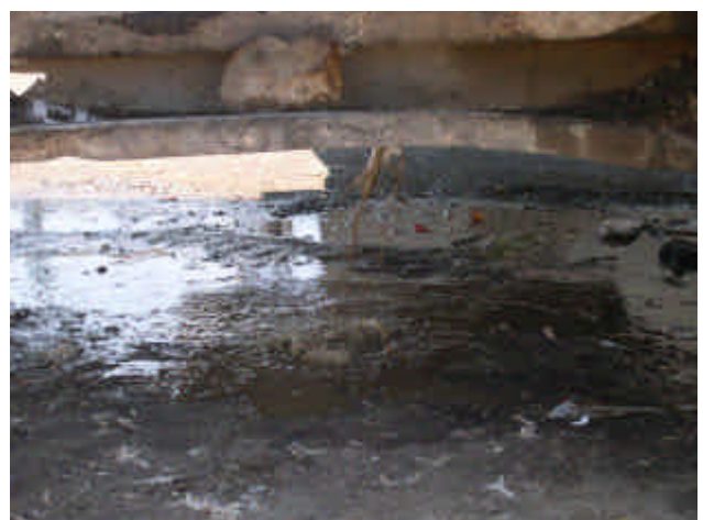
コンパクター下からの浸出水の漏出
