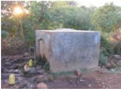
給水施設兼減圧水槽 (モラ湧水)
