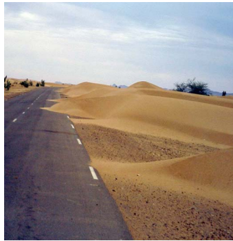
道路の飛砂被害
