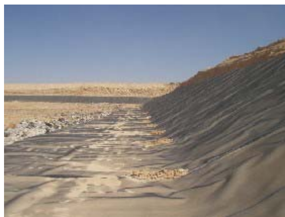
図 12：第1セルの浸出水収集シート
