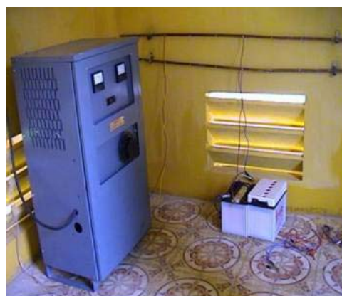
図 3-44 バッテリー充電装置
