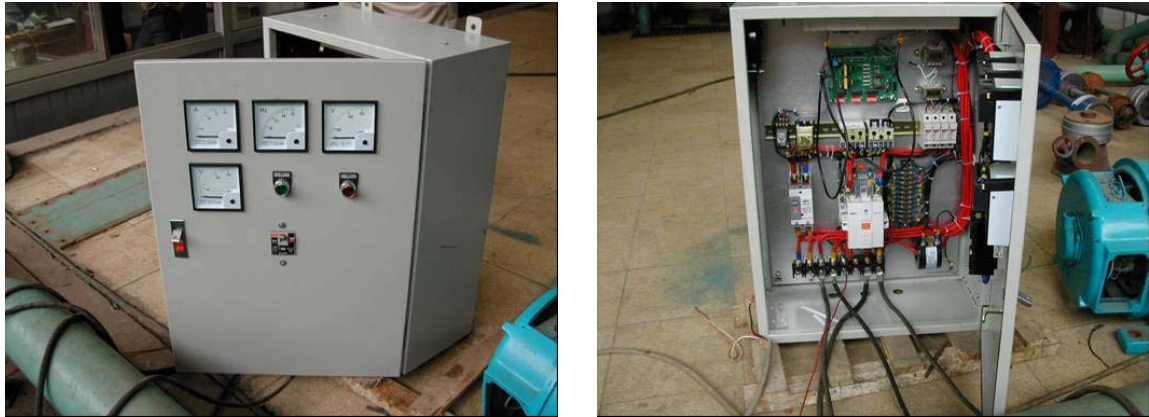
図 4-5-5 制御盤 (外部-左と内部-右)
