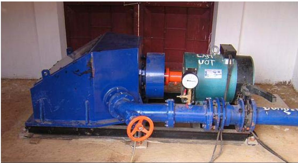
図 3-4-2 水車発電機（左が水車、右が発電機）
