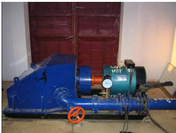
水車・発電機
