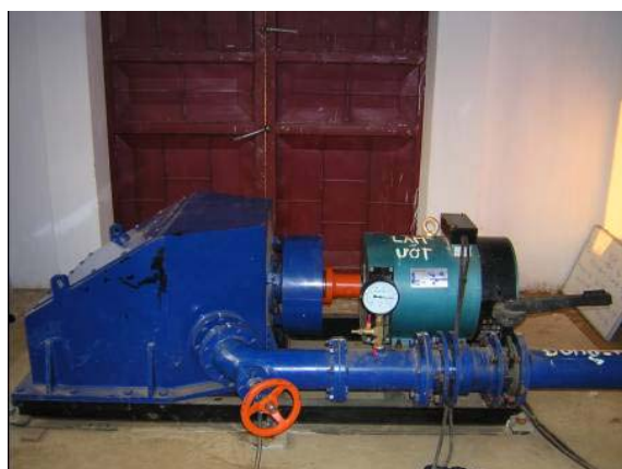
水車・発電機
