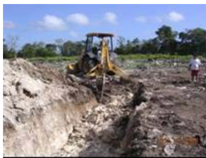
Relleno Sanitario Manual Nótese la calidad del suelo
