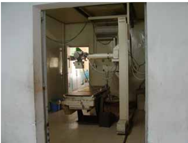
X線透視撮影装置 - 外来検査棟 (20年以上経過し、修理不能である)
