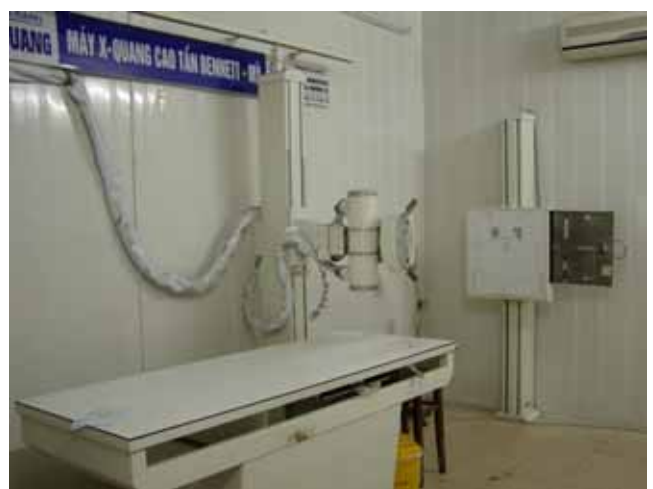
X線一般撮影装置 - 外来検査棟 (老朽化により、一部機能が故障している)
