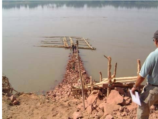
図 2.6 パッカダンの捨石水制工 -2002 年 2 月の状況-
