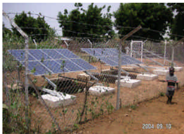
写真 4-4 Ahoto 村/ Jigawa 州 (レベル PV) ソーラーポンプの PV アレイの内 1 ストリング が何者かに持ち去られて、現在 2/3 容量で 運転している。
