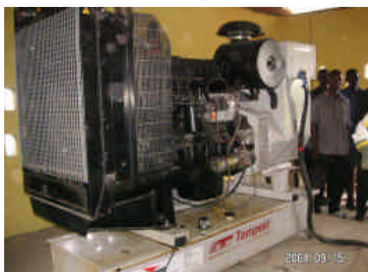
写真 5-4 Ode Etikan 村/Ondo 州 全村独立グリッドによるレベル-5 の電化 村。電化製品も、冷蔵庫・アイロン・扇風 機まであった。128kW ディーゼル発電機 2 台で全村 1 万人の村へ配電を行っている。
