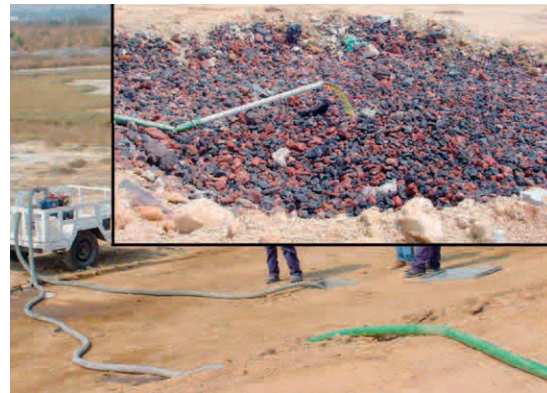
写真2-8 メキシコ市の埋立処分場における浸出水の再循環処理設備
