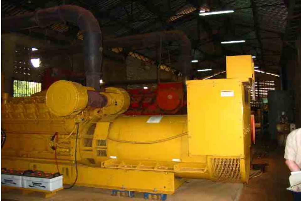
1, 125kW のディーゼル発電機
