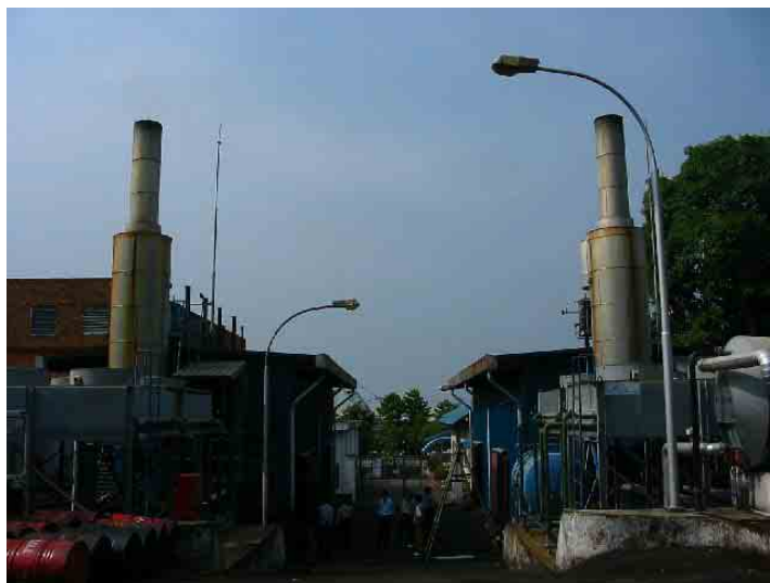
EDC シアヌークビルの発電所
