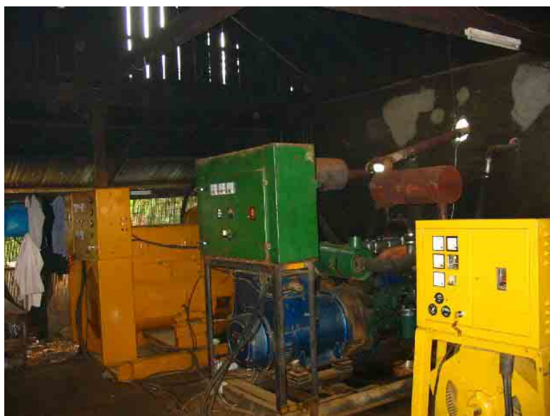
REE が使用している発電機
