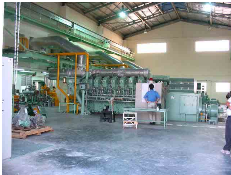
建屋の中。稼動中の三菱重工製ディーゼル発電機
