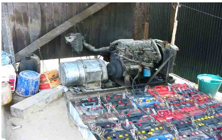
充電中のバッテリー
