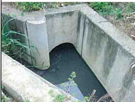
アレニージャスの下水管流末（ウカ地区）・運河を経由して海に放流
