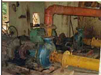
老朽化した揚水ポンプ
