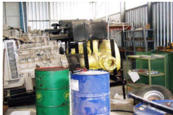
写真 6：ハフォソ中央倉庫の灌漑ポンプ
