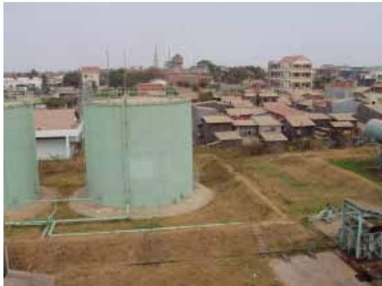
既存燃料タンク
