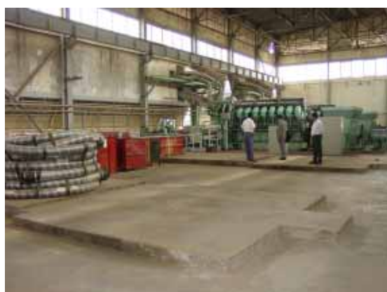
既存2号発電設備と将来用基礎 外見はコンクリートであるが中身の一部に砂が充填されている。コンクリート強度も脆さを示しており本計画では撤去する予定
