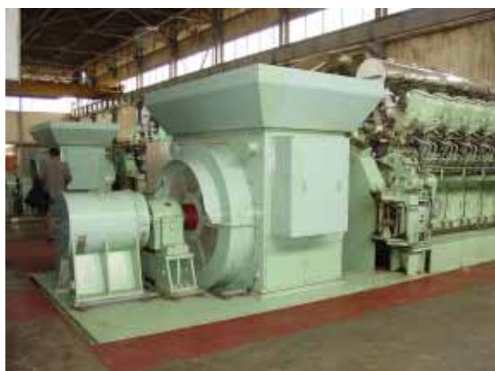
既存1号および2号発電設備 現在ディーゼル油焚きで運転されている。
