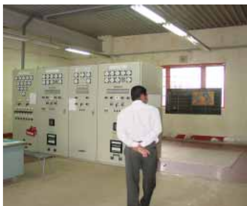
既存発電設備監視・制御盤 EDCは15kV高圧盤の開閉操作を遠隔で行うため、左端に操作用の盤を自己負担で設置した。
