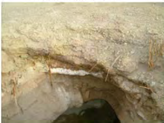
カレーズ立て抗にみられる地表面から 数十cmのところに見られる塩類化層
