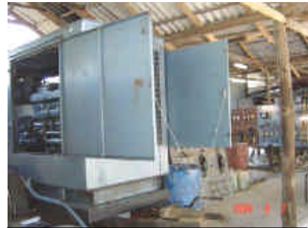
手前は 250 kVA 可搬形ディーゼル発電機セット、奥にあるのは配電盤。 この配電盤の後ろにディーゼル発電
