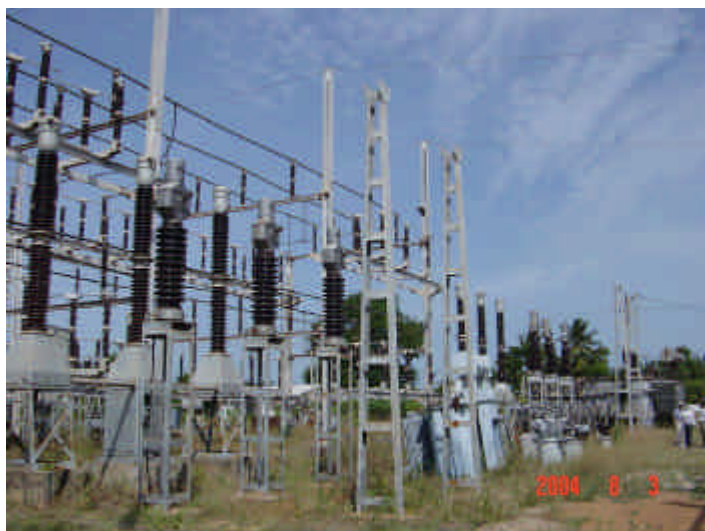
Chunnakam 変電設備
