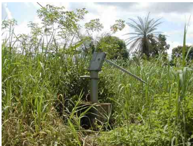
Bojongo'a Mbedi (対象村落外) BIP(公共投資)予算で3年前に建設されたハンドポンプ付き深井戸。水質が悪いため、使用されずに放棄されている(鉄濃度が高い)。
