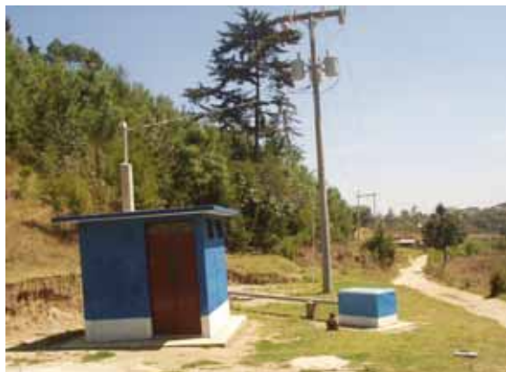
CHIMALTENANGO県 PANABAJAL COMALAPA 既存給水施設(深井戸、操作室)
