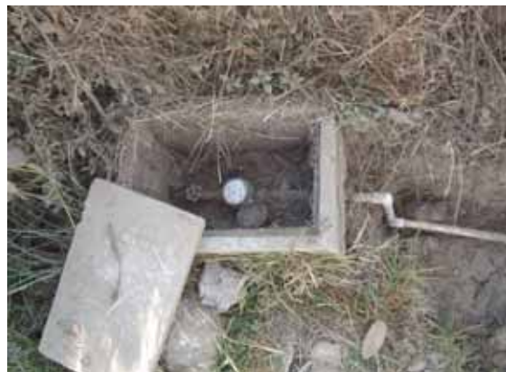
HUEHUETENANGO県 CHACARITA 既存給水施設(各戸給水用水道メーター)
